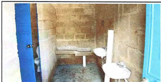
Foto 5: Vista de lavamanos de baño
